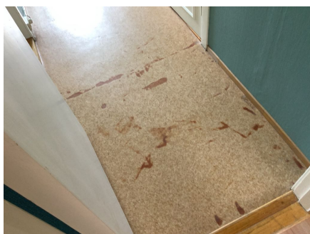
Merker på belegg på gulv.
