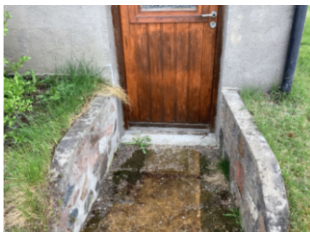
Forstøtningsmurer mot kjellerinngang har skjevheter.
