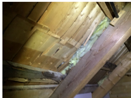
Eldre flisundertak har hull. Det er lagt ny undertakspapp over eldre undertak
