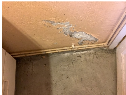
Saltutslag og malingsflass på innsiden av mur.
