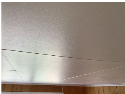
Merker etter tidligere vannskade fra overgang tak/vegg for tilbygget stue.
