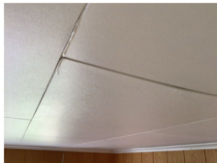
Folieslipp på himlingsplater.
