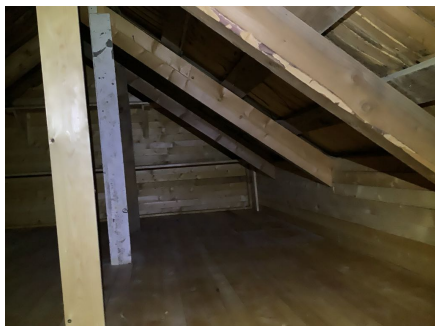
Møneloft mangler lufting i gavler..
