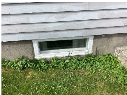
Vinduer fra byggeår har vedlikeholdsbehov.
