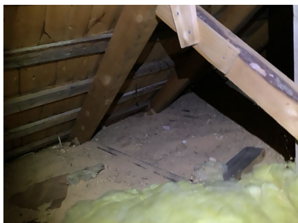
Begrenset med isolasjon på møneloft.
