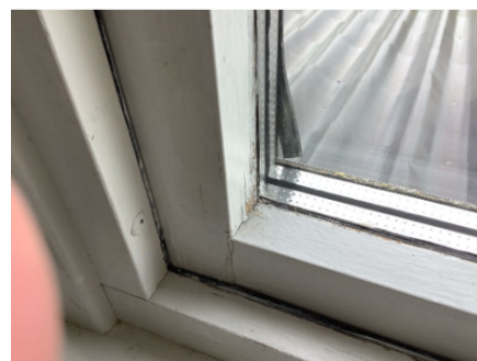
Det er registrert kondensmerker og pakning som har løsnet utvendig.
