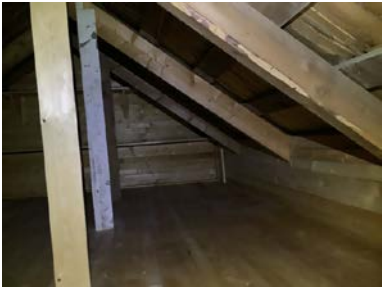
Møneloft mangler lufting i gavler..
