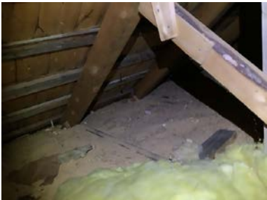
Begrenset med isolasjon på møneloft.
