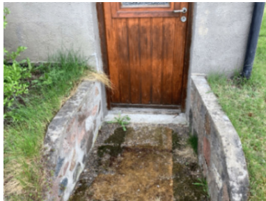
Forstøtningsmurer mot kjellerinngang har skjevheter.
