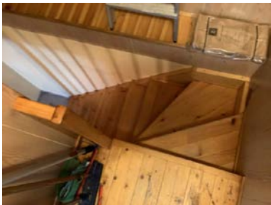
Trapp til kjeller mangler håndløper og rekkverk.
