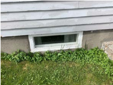
Vinduer fra byggeår har vedlikeholdsbehov.
