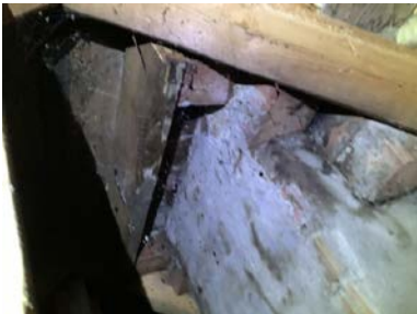
Kondensmerker rundt pipe. Merker var tørre på befaringen.
