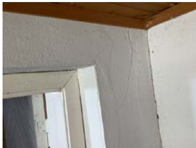
Rissprekker i grunnmur er registrert.
