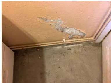
Saltutslag og malingsflass på innsiden av mur.
