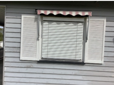
Solavskjerming på enkelte vinduer.
