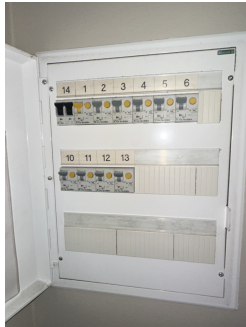
Sikringsskap med automatsikringer.
