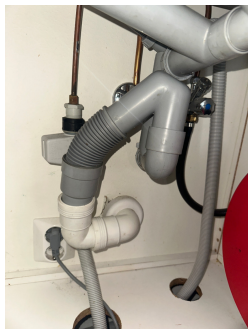
Rørapplegg i kjøkkenbenk i leilighet
