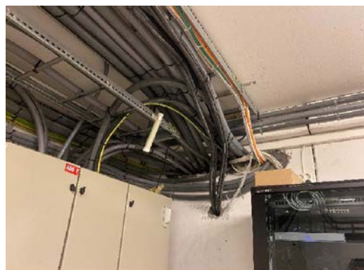
Stigeledninger i tavlerom
