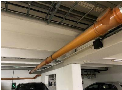
Bunnledninger er lett tilgjengelige i parkeringskjeller
