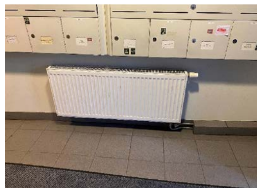
Konvektor i oppgang
