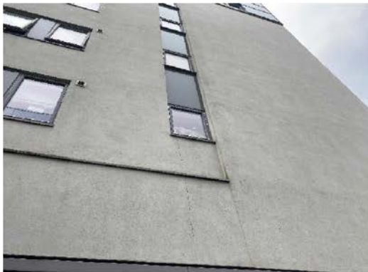
Behov for rengjøring av alle fasader
