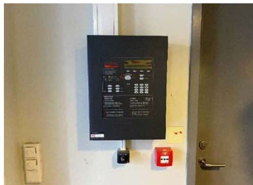
Brannpanel i oppgang med serviceavtale
