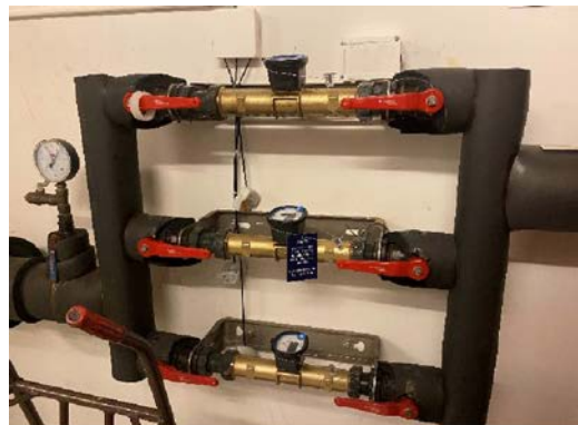
Vanninnlegg med målere
