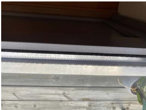
Vindu i befart leilighet er datert 2009
