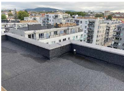
Defekt varmekabel vil føre til skader
