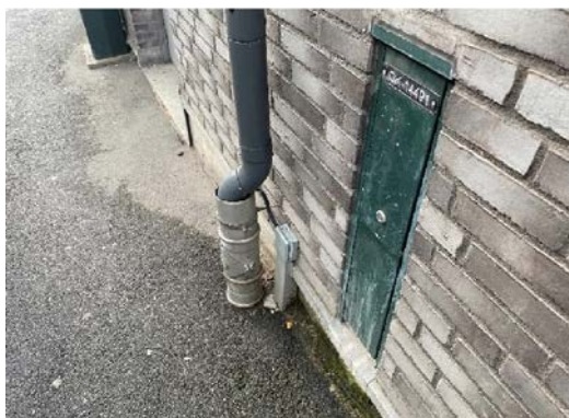
Varmekabler må kontrolleres jevnlig
