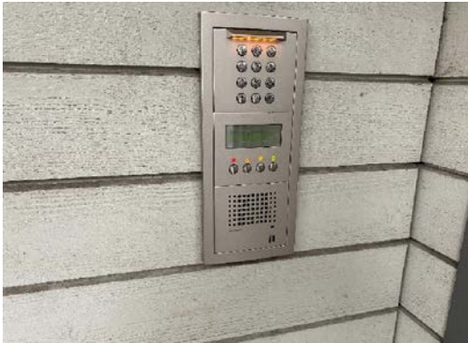
Betjeningspanel fra byggeåret
