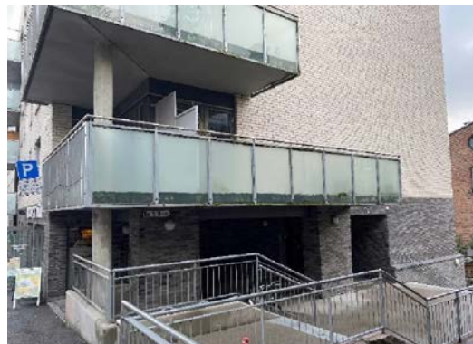
Kraftig groing på dekkekant. Tiltak er nødvendig
