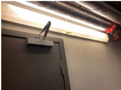
Belysningsarmatur i kjeller
