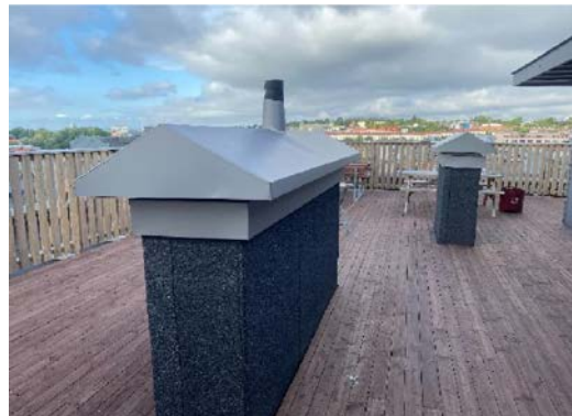
Ventilasjonsavkast over tak
