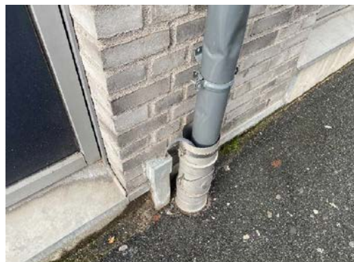
Koblingsboks ved fortau
