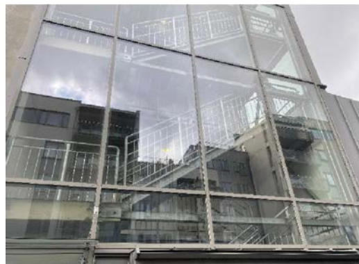
Trapper i materialer av galvanisert stål
