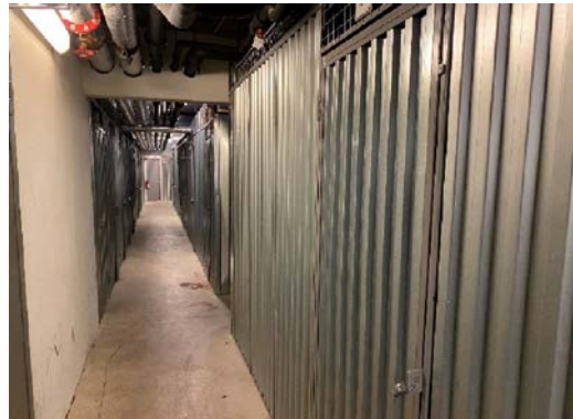
Støtskader i metallprofiler
