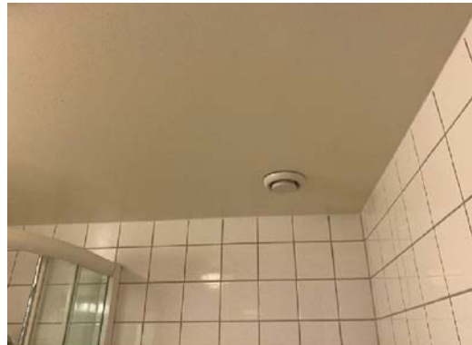
Avtrekk i våtrom
