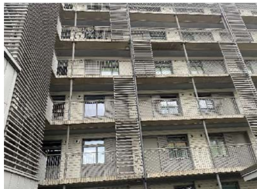
Trekledning med behov for overflatebehandling
