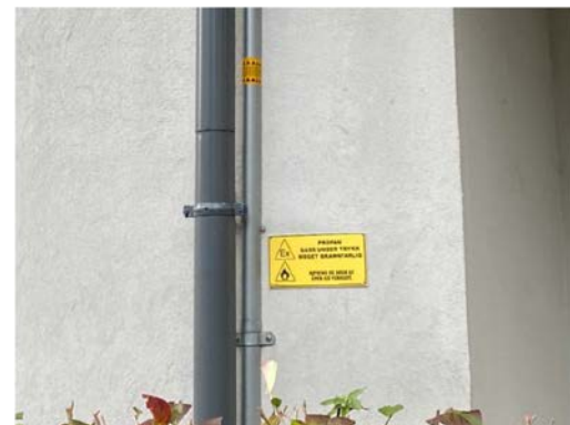
Gassrørledning på fasade
