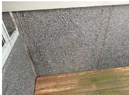
Noe varmebobling i papp
