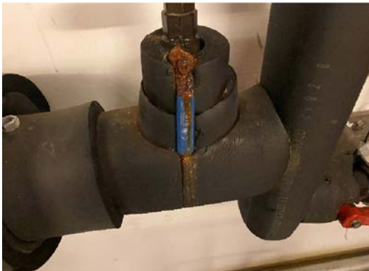
Rust på kran. Kraner må funksjonstestes regelmessig
