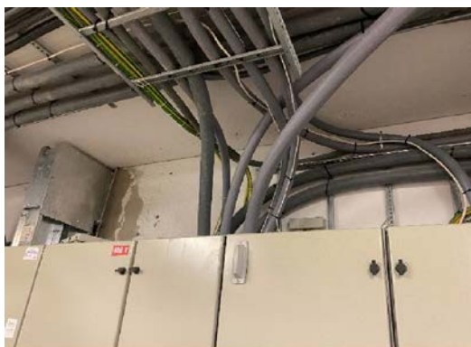
Inntakskabler, stigeledninger og hovedtavle
