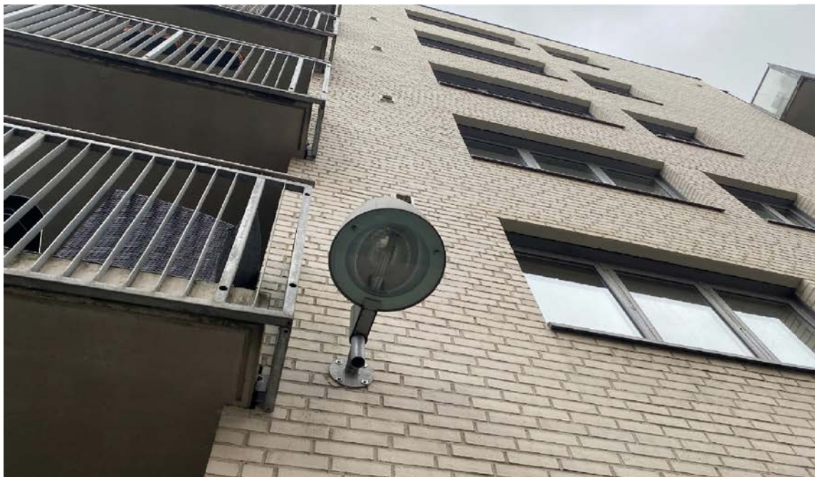
Belysningsutstyr på fasade
