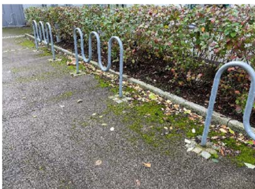
Mose bør fjernes løpende
