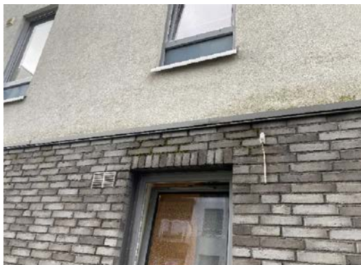
Mosegroing i fuger må fjernes.
