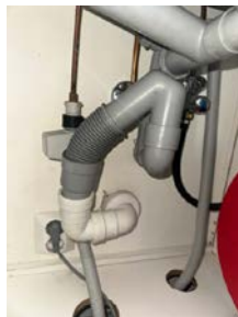
Røropplegg i kjøkkenbenk i leilighet
