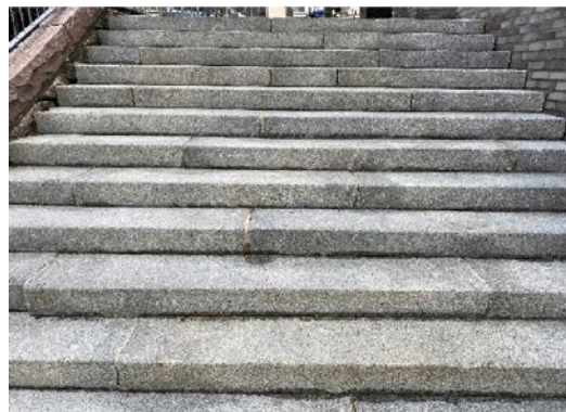
Oppsprekking i fuger
