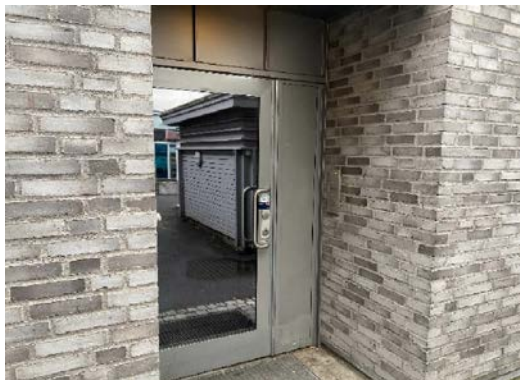
Skader bør utbedres løpende
