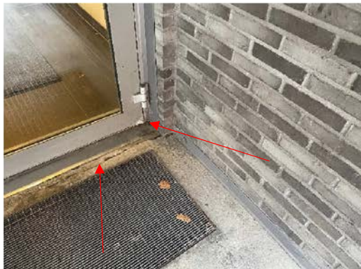
Skader på dør og betongdekke
