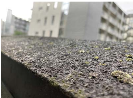
Mosegroing på avfallshus bør fjernes
