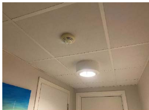
Systemhimlinger i korridorer med enkelte skader
