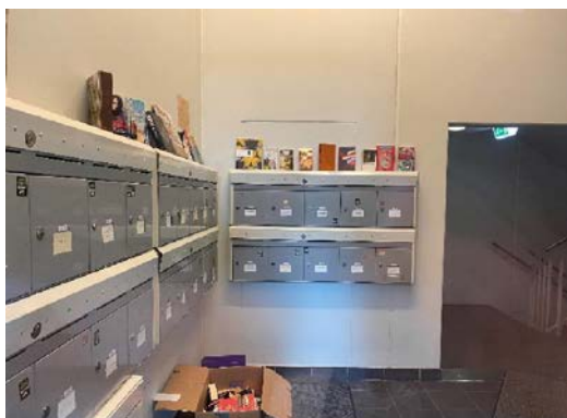
Bruksslitasje på overflater
