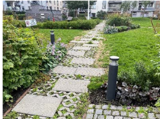
Pullertbelysning er utsatt for jordfeil
