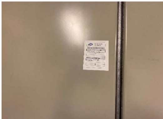
Elektrisk anlegg må kontrolleres regelmessig
