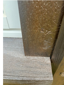
Lister står tett ned til vannbrett
