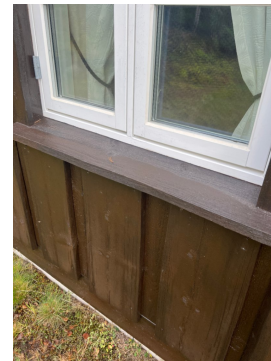
Ikke montert beslag på vannbrett
