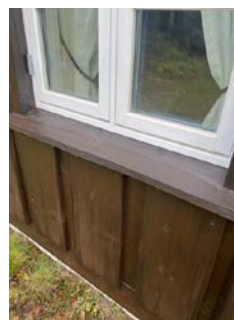
Ikke montert beslag på vannbrett
