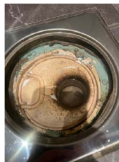
Membran ligger opp på klemring i sluket
