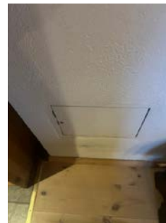
Ikke ildfast plate på gulv under sotluke
