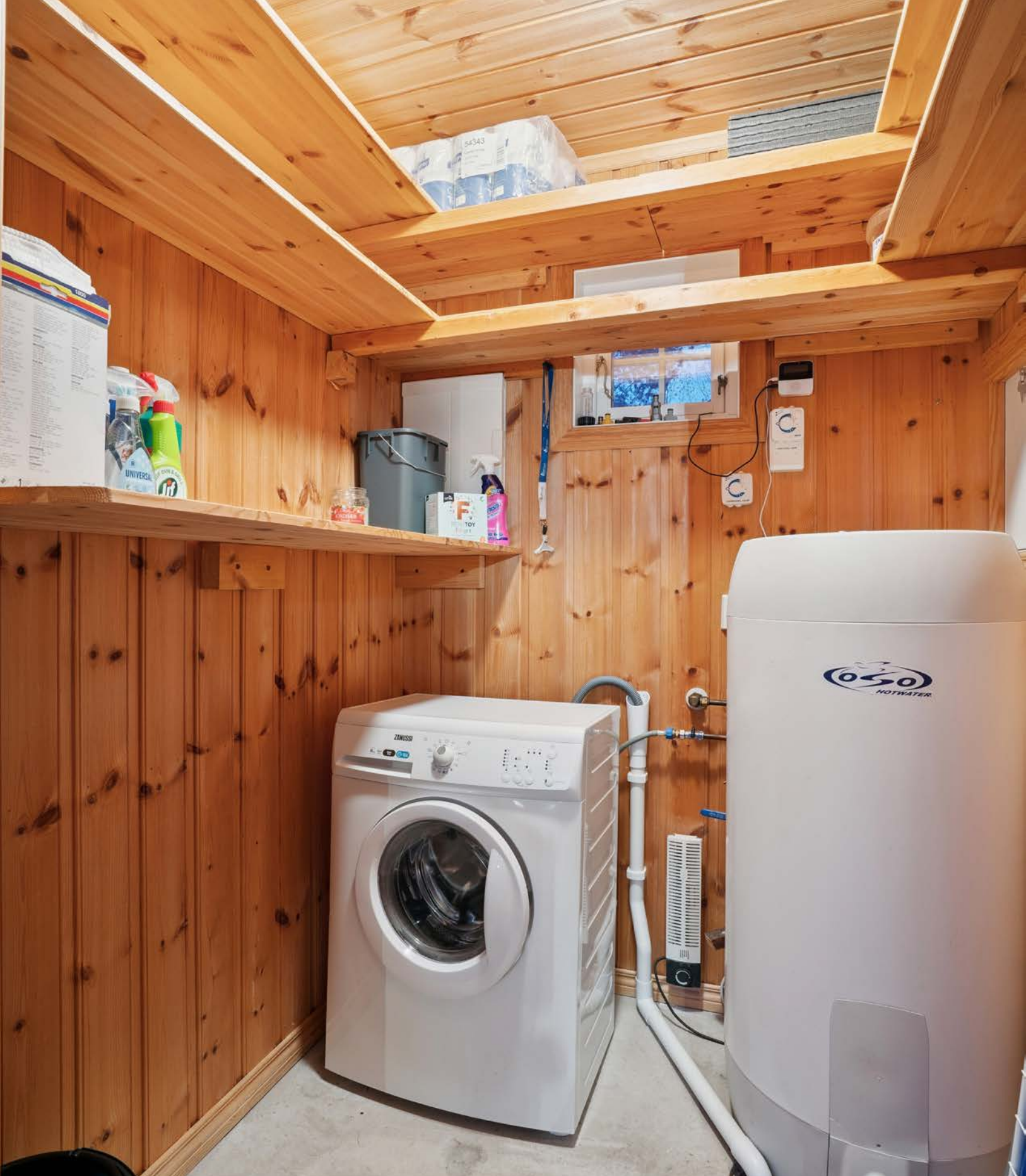
Bod med opplegg for vaskemaskin.
