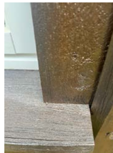
Lister står tett ned til vannbrett
