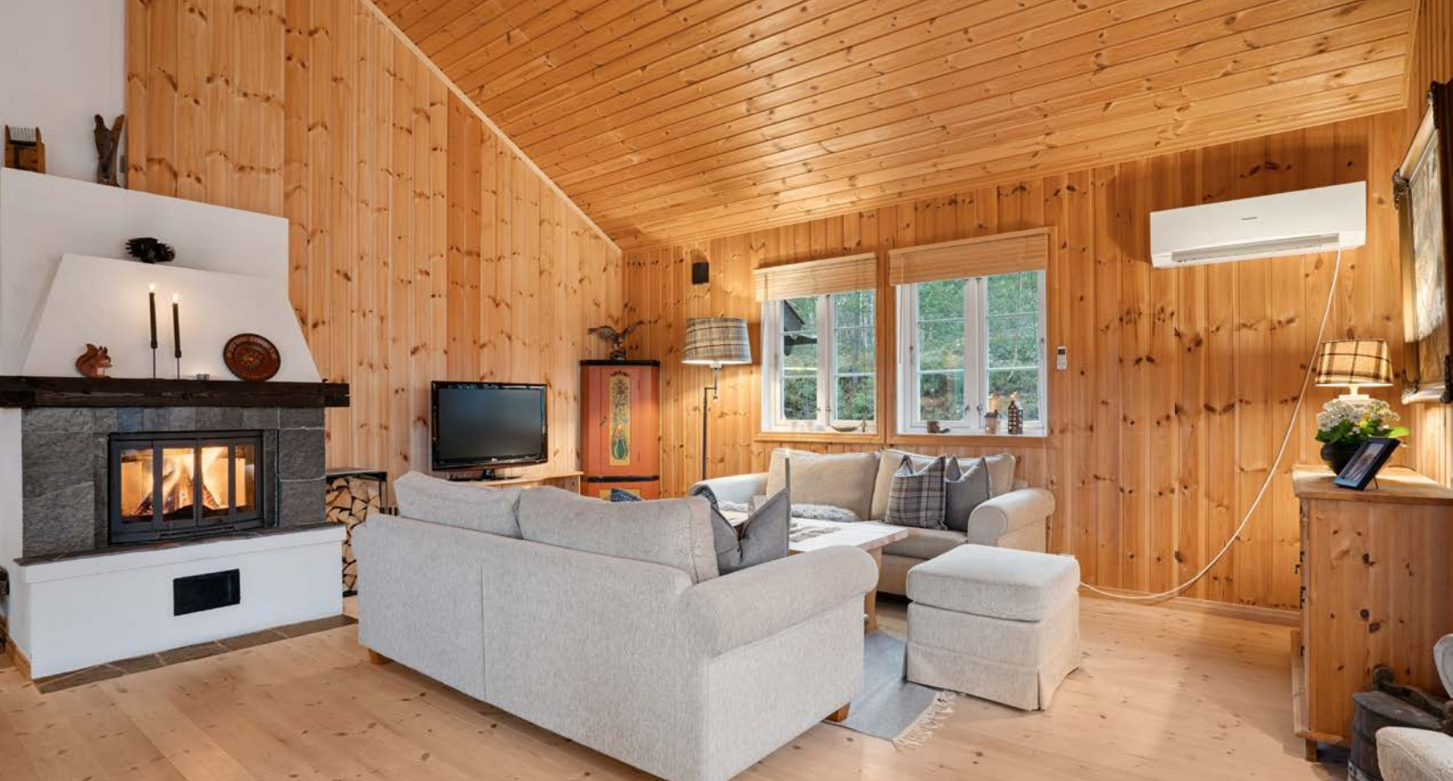
Luft til luft varmepumpe i stue.
