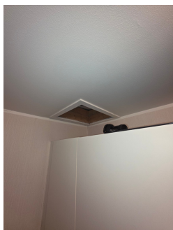
Fastmonterte garderobeskap hindrer tilkomst til "kaldloft"
