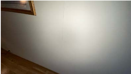
Sprekk i veggplater stue.
