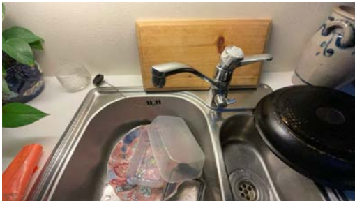
Kran kan ikke side forsyves.
