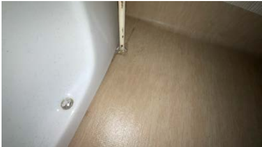
Belegg på vannrør er ikke trekt opp 25mm på rør.
