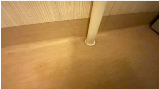
Belegg er ikke trekt opp 25mm på rør.
