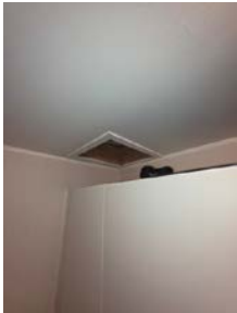
Fastmonterte garderobeskap hindrer tilkomst til "kaldloft"
