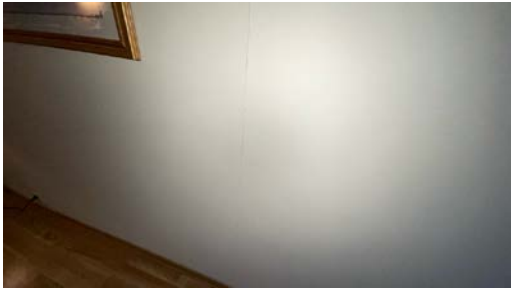
Sprekk i veggplater stue.
