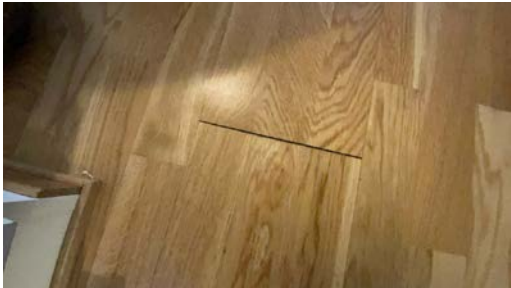
Parkett har sprekker i skjøter
