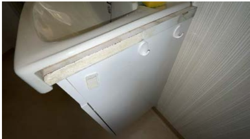
Kant laminering er skadet på benkeplate
