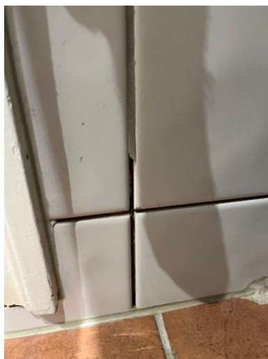
Sprekk i fugemasse
