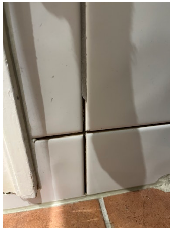
Sprekk i fugemasse
