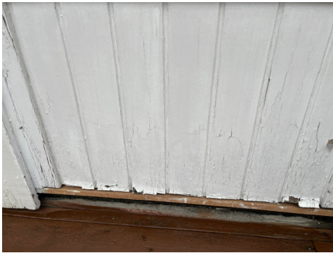
Store svelleskader i balkongdør.
