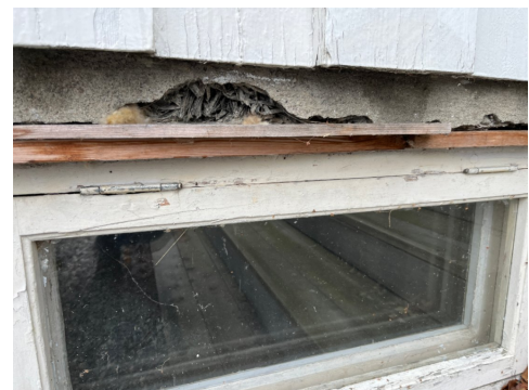
Glippe/åpning mellom karm og mur.
