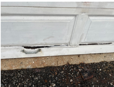
Store råteskader i port.
