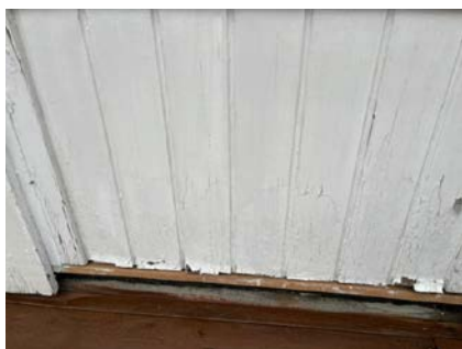
Store svelleskader i balkongdør.
