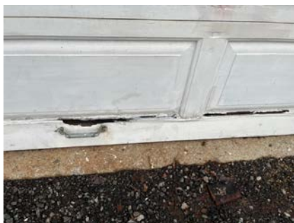
Store råteskader i port.
