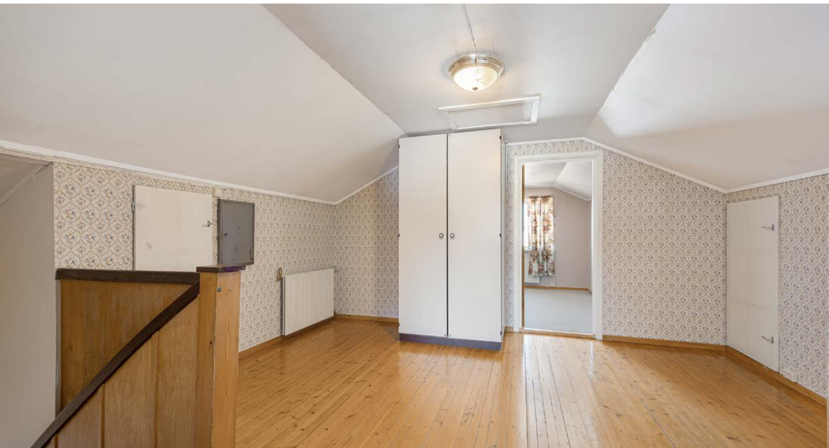
Takhøyden i 2. etasje er kun ca. 207 m, og dette er for lavt i forhold til dagens krav til rom med varig opphold.
