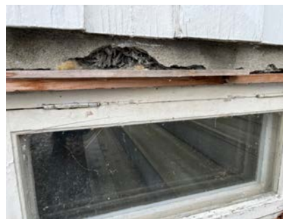
Glippe/åpning mellom karm og mur.
