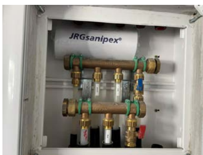
Fordelerskap på bad 1. etasje
