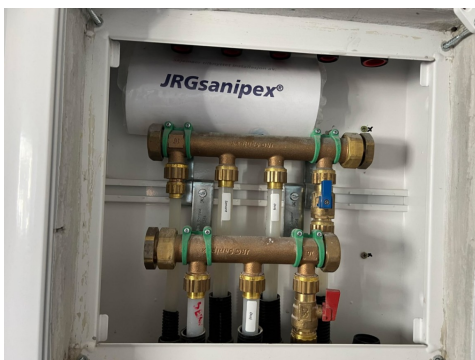
Fordelerskap på bad 1. etasje
