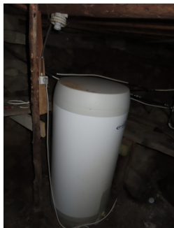
Nyere 200 liters varmtvannsbereder i jordkjeller.
