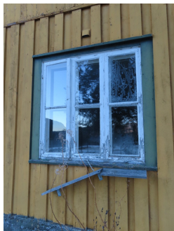
Vinduer med ukjent alder - tilstandsgrad 3.
