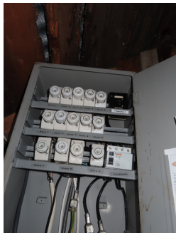
Sikringsskap oppe på kaldloftet. Skrusikringer/porselenssikringer.
