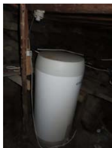
Nyere 200 liters varmtvannsbereider i jordkjeller.
