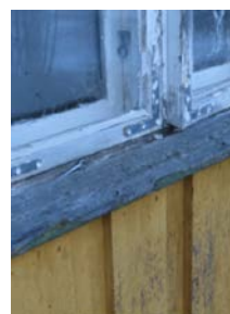
Spalte direkte inn i vegg under vinduer.
