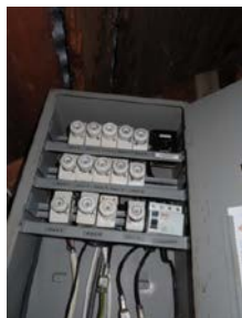
Sikringsskap oppe på kaldloftet. Skrusikringer/porselenssikringer.
