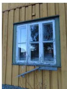
Vinduer med ukjent alder - tilstandsgrad 3.
