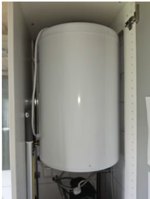
Bilde viser varmtvannsbereder.
