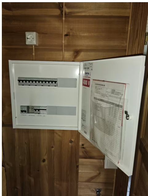
Bilde viser sikringsskap.
