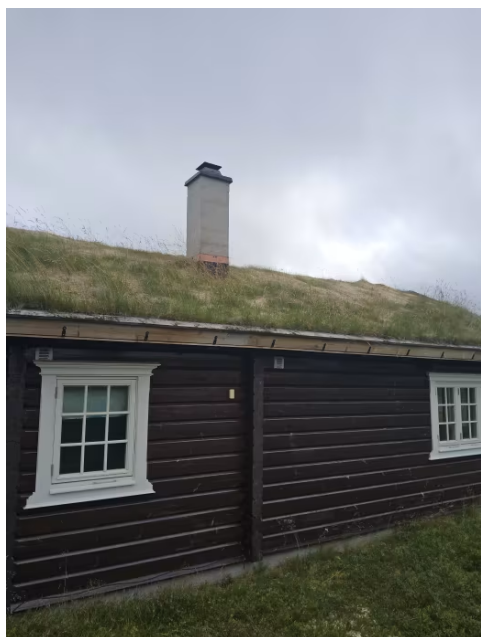
Bilde viser manglende takstige.
