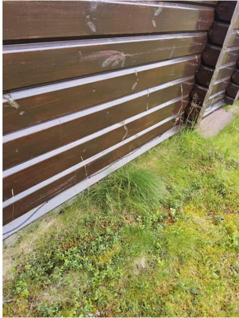
Bilde viser tømmervegg avsluttet for nærme terreng.
