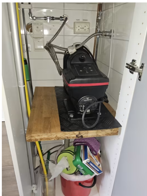
Bilde viser vannpumpe.
