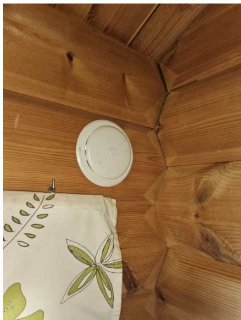
Bilde viser luftventil.
