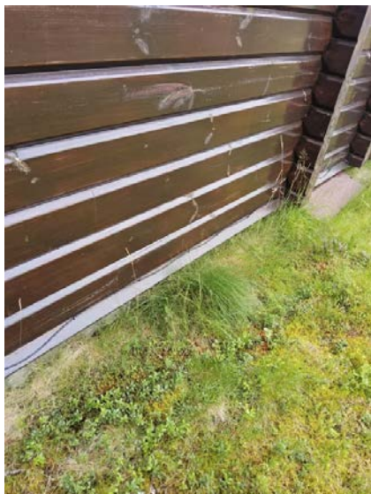
Bilde viser tømmervegg avsluttet for nærme terreng.
