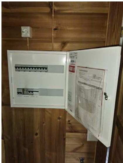
Bilde viser sikringsskap.
