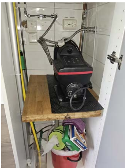
Bilde viser vannpumpe.
