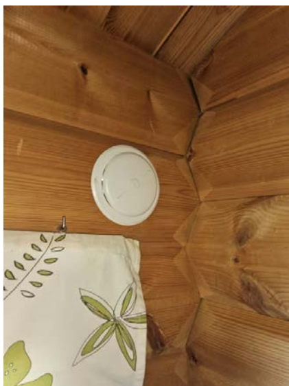
Bilde viser luftteventil.
