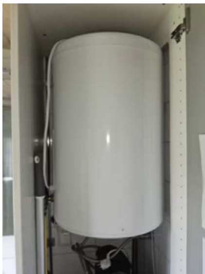
Bilde viser varmtvannsbereder.
