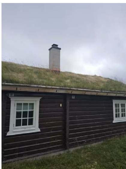
Bilde viser manglende takstige.
