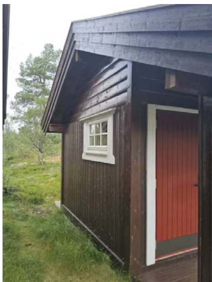
Bilde viser yttervegg ført for nærme terreng.
