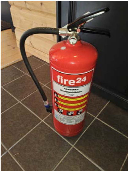
Bilde viser brannslukningsapparat.
