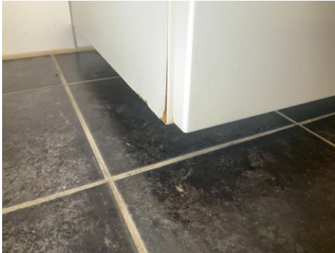
Delaminering nederst på servantskapet.
