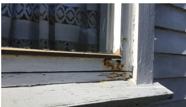
Råteskader i nedkant
