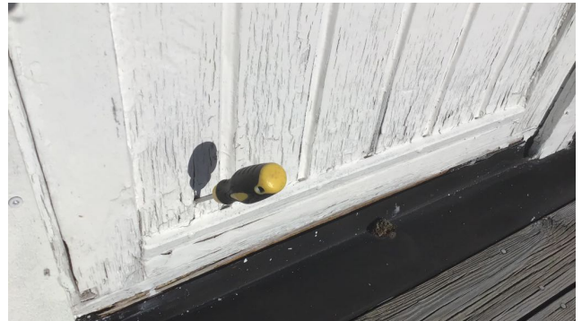
Fukt i nedkant dørblad
