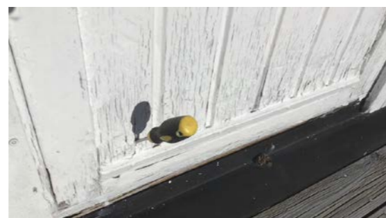
Fukt i nedkant dørbord
