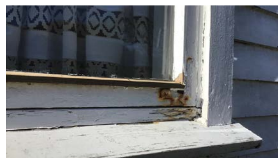
Råteskader i nedkant
