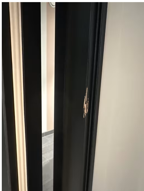
Viser hakk i karm ved ytterdør.
