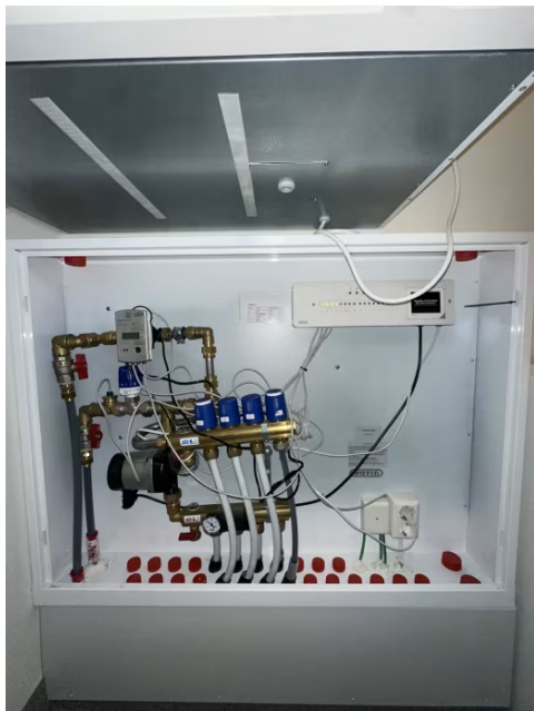
Viser fordelerskap plassert på teknisk rom.
