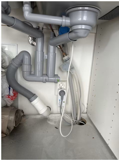
Viser vann og avløpsinstallasjoner under kum.
