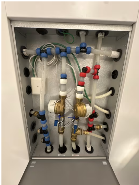
Viser fordelerskap plassert i himling på bad.
