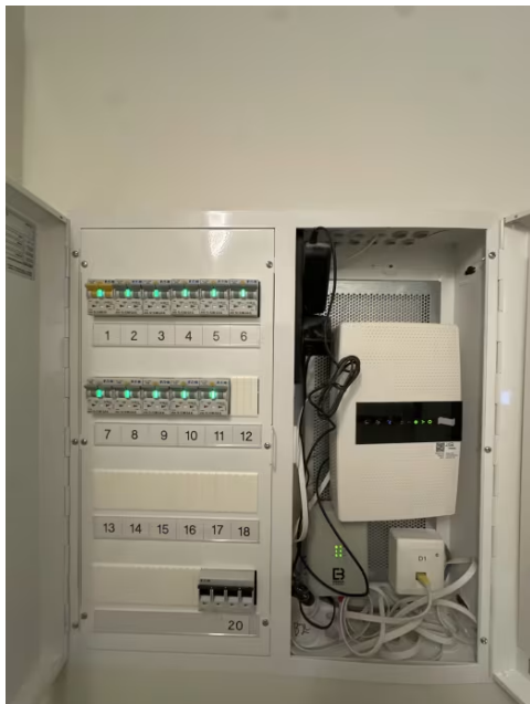
Viser innfelt sikringsskap med automatsikringer og ekom del plassert på teknisk rom.
