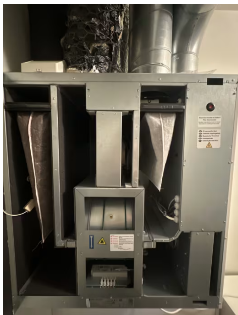
Viser innvendig balansert ventilasjonsaggregat, ingen tegn til fukt eller mugg i filter.
