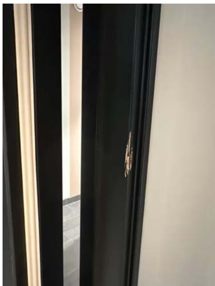
Viser hakk i karm ved ytterdør.
