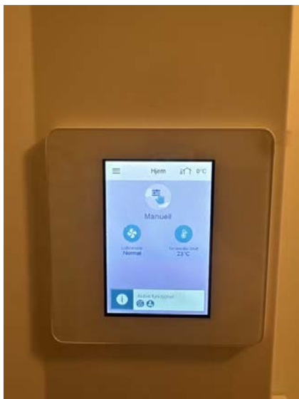
Viser display aggregat, ingen feilmeldinger registrert.
