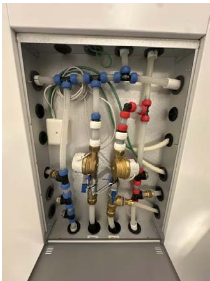
Viser fordelerskap plassert i himling på bad.
