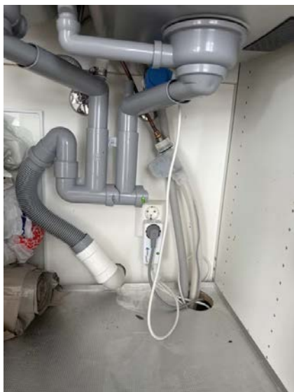
Viser vann og avløpsinstallasjoner under kum.
