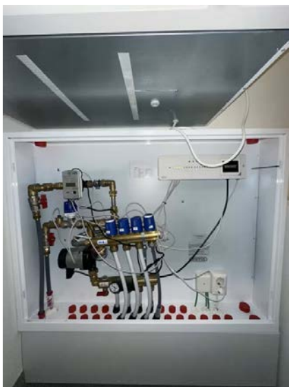
Viser fordelerskap plassert på teknisk rom.
