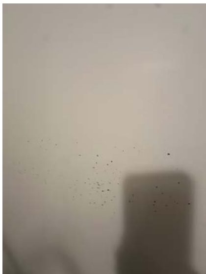
Det registreres hakk/sår i vegg på teknisk rom.
