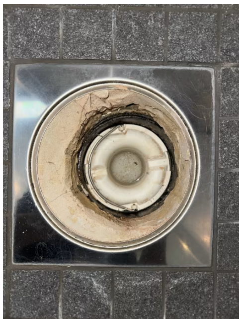
Viser sluk i dusjonen.
