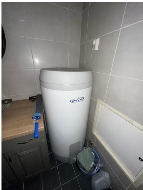
Viser bereder plassert på vaskerom.
