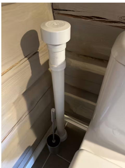
Viser vakumventil på bad i 2.etasje.
