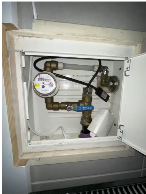
Viser vanninntak, hovedstoppekran og vannmåler.
