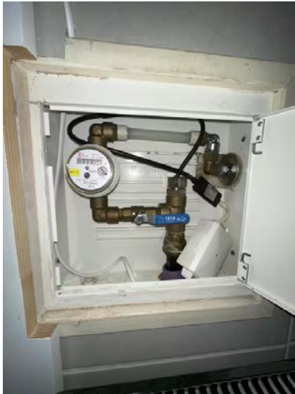
Viser vanninntak, hovedstoppekran og vannmåler.
