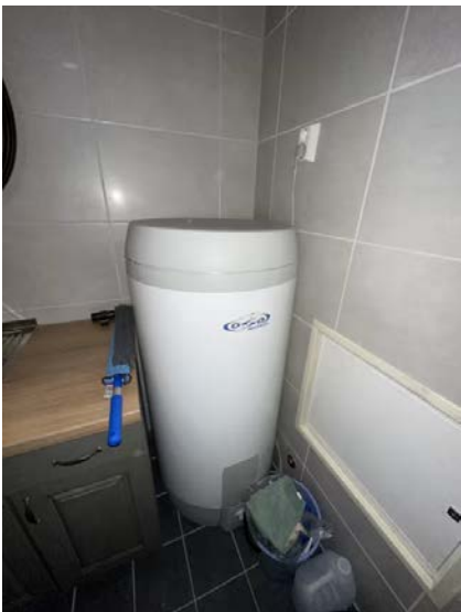
Viser bereder plassert på vaskerom.
