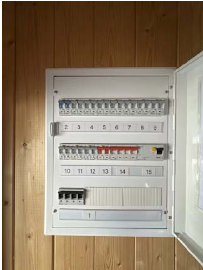
Viser sikringskap plassert i bod med utvendig adkomst.
