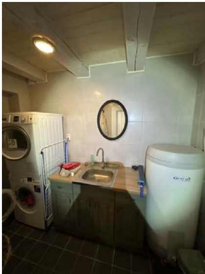
Viser innredning, bereder og opplegg for vaskemaskin.
