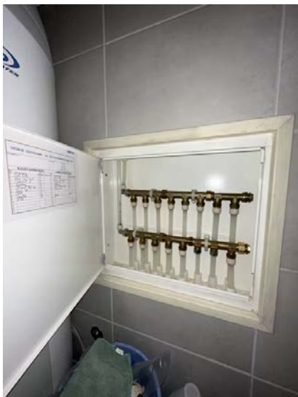
Viser fordelerskap plassert på vaskerom.
