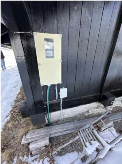
Viser utvendig målerskap.
