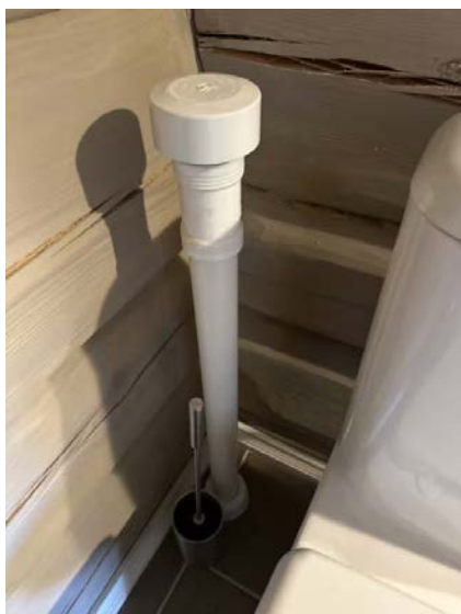
Viser vakumventil på bad i 2.etasje.
