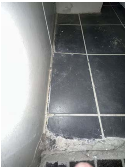
Viser sprekke i overgang gulv og vegg.
