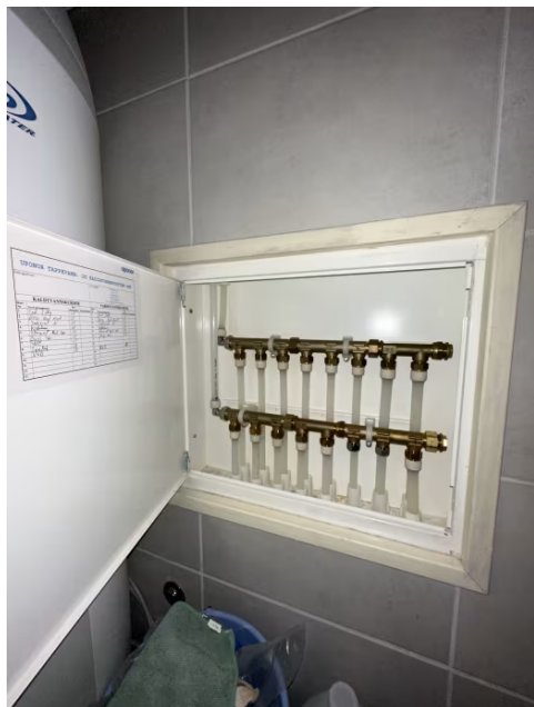
Viser fordelerskap plassert på vaskerom.
