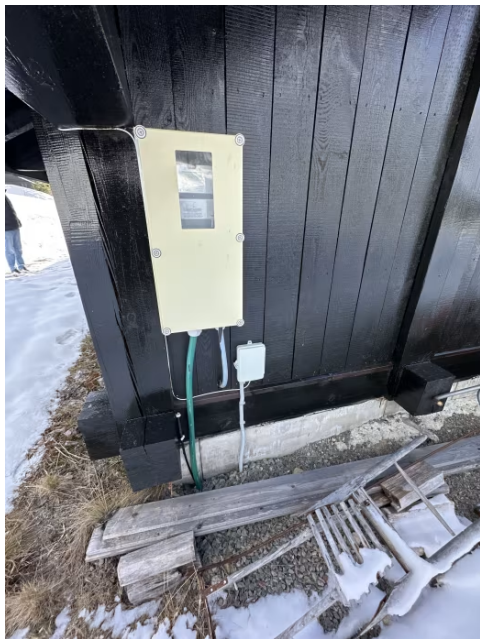
Viser utvendig målerskap.
