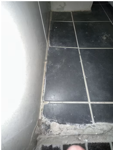
Viser spekk i overgang gulv og vegg.
