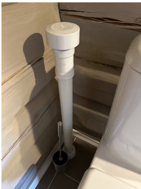
Viser vakumventil på bad i 2.etasje.
