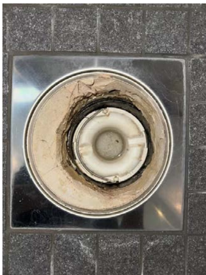
Viser sluk i dusjsonen.
