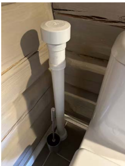
Viser vakumventil på bad i 2.etasje.
