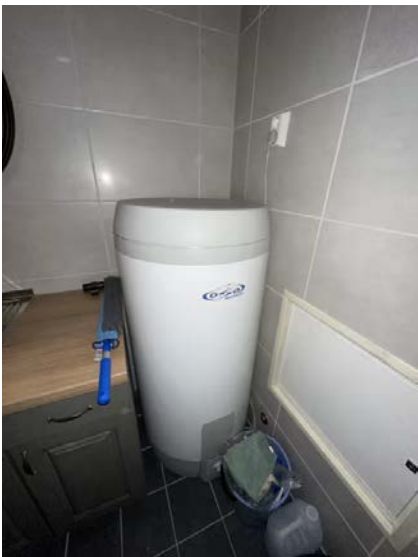
Viser bereder plassert på vaskerom.
