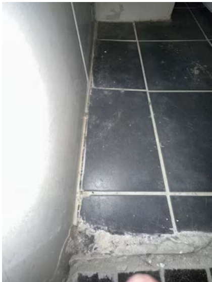
Viser sprekke i overgang gulv og vegg.
