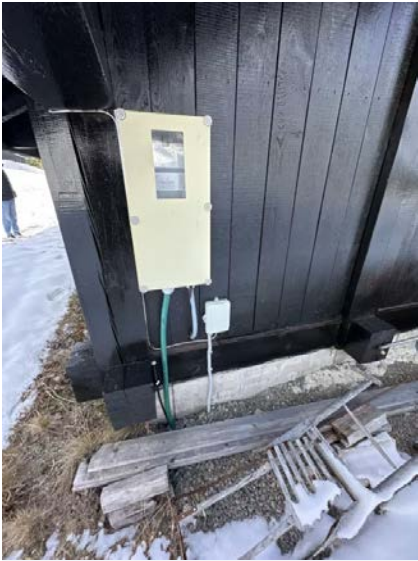
Viser utvendig målerskap.
