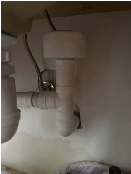
Viser lufting med vakumventil på bad i 1.etasje
