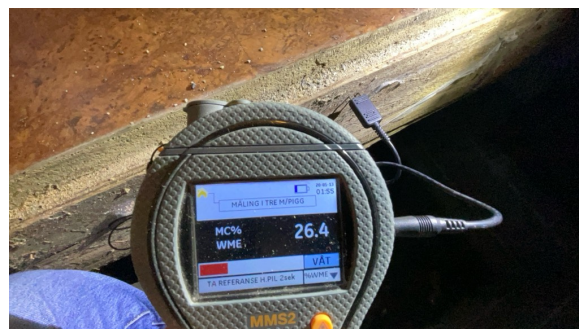
Råte og høye fuktverdier.
