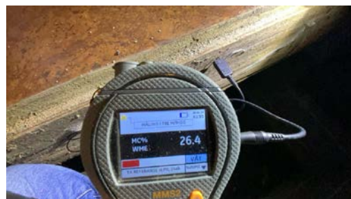
Råte og høye fuktverdier.
