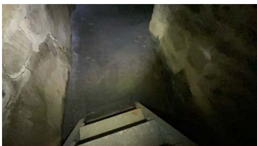
Stående vann i krypkjeller under den eldste delen.
