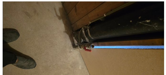
Utkoblet stoppe kran
