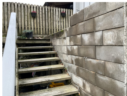
Skjevheter i muren.
