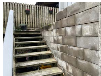
Skjevheter i muren.
