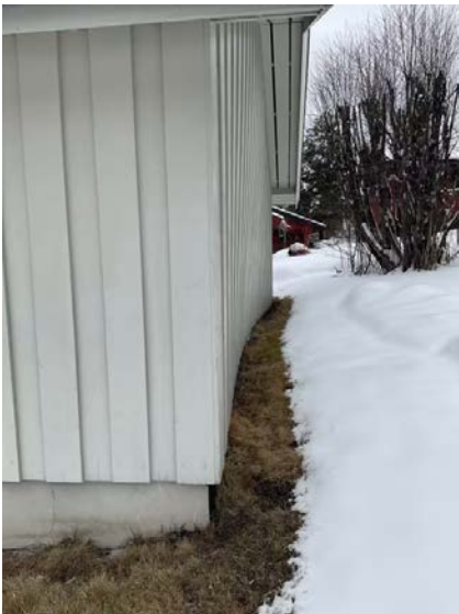
Bakvegg i garasjen har skidd inn.
