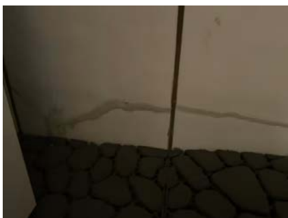
Sprekk i fliser.
