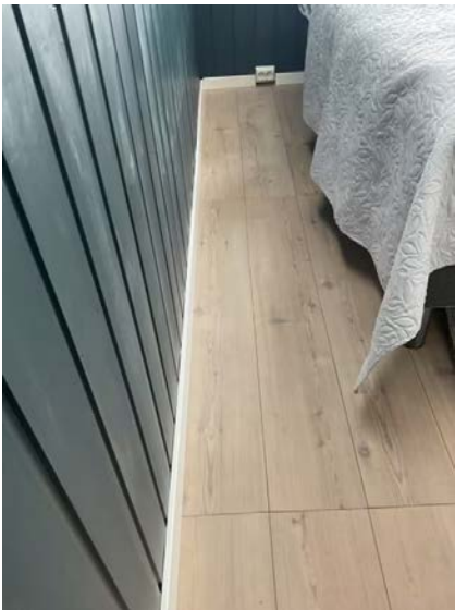
Ufagmessig gulv i tilbygg.
