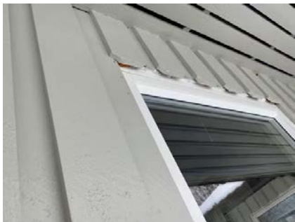
Synlig byggsaum over vindu.
