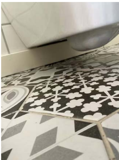
Ikke drenshull under wc.
