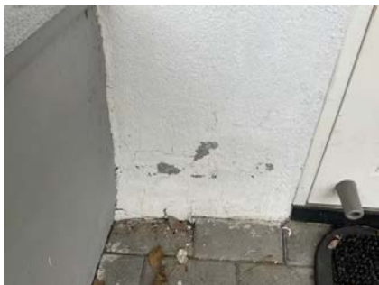
Sprekk/flass i puss.
