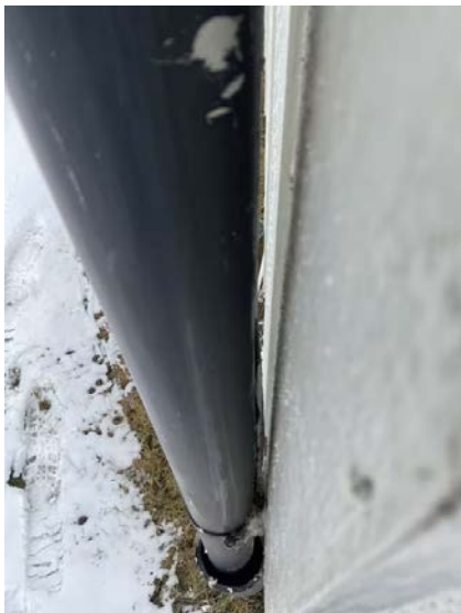
Frostspreg i nedløp.
