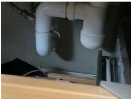
Utett gjennomføring gjennom vegg.
