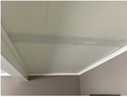
Manglende sparkling og maling.
