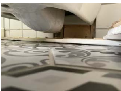
Ikke fliser under wc.
