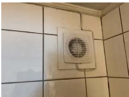
Avtrekksvifte i vegg.
