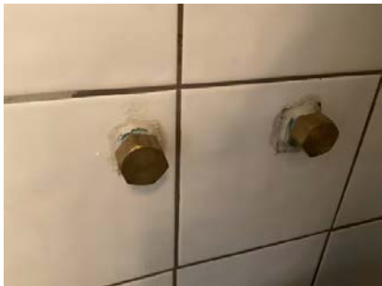
Gjennomføringer i vegg er tettet med silikon.
