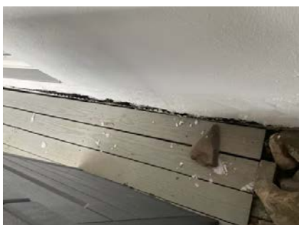
Manglende topplist til grunnmursplast.
