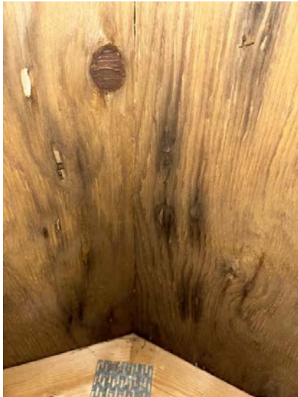
Misfarging i undertak.
