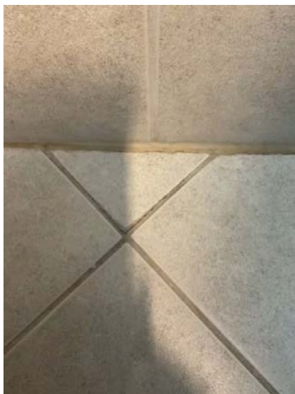
Sprekker i fugemasse.
