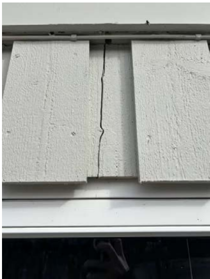
Sprekk i panelbord.
