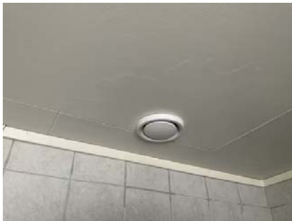
Fuktmerker rundt ventilasjon i tak.
