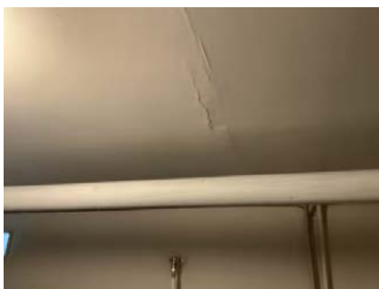
Manglende sparkling og maling.
