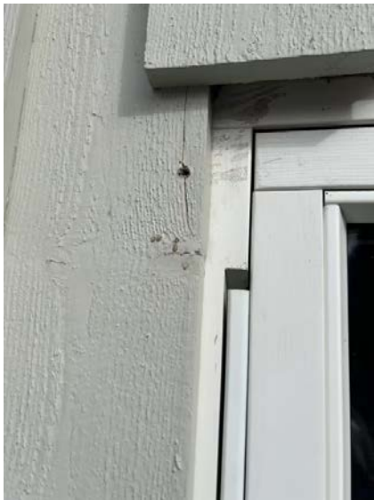
Sprekk i panelbord.
