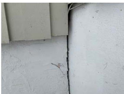
Viser utsklidd ringmur.
