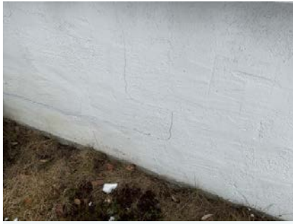
Sprekk i lettklinker.
