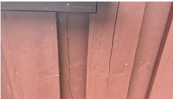
Eksempel på sprekker i kledning.
