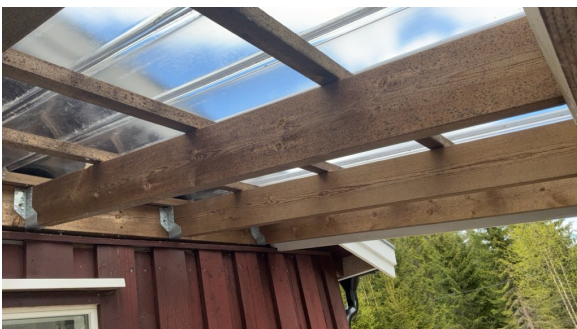
Svertesopp på takkonstruksjon.
