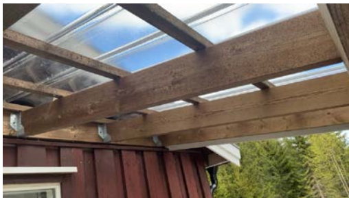
Svertesopp på takkonstruksjon.
