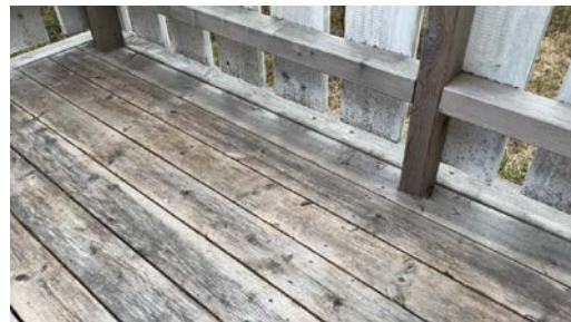
Noe slitasje på overflater.
