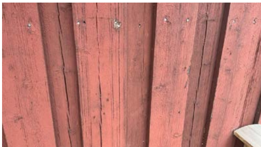
Eksempel på sprekker i kledning.
