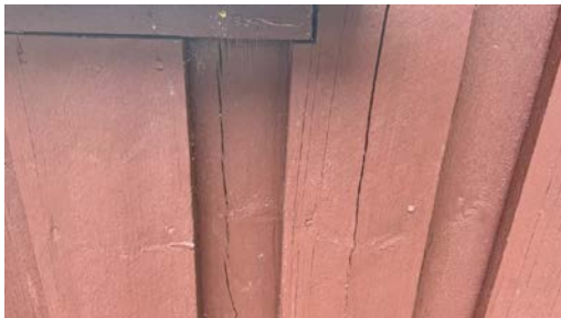
Eksempel på sprekker i kledning.
