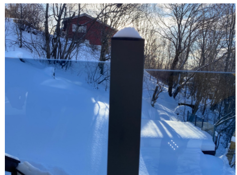
Enkelte trappinger i glassrekkverk.
