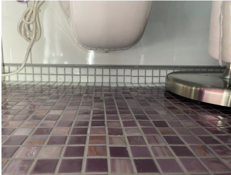
Ingen synlig drensåpning.
