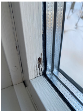
Påbegynt råteskade i vindu på soverom.
