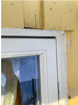
Manglende vannbrett/beslag over dør.
