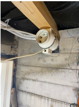
Det er etablert avtrekksvifte i krypkjelleren.
