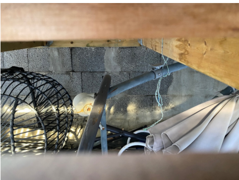
Ingen synlig fuksikring mot mur.
