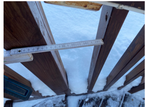
Åpninger i rekkverk fra 10-14 cm.
