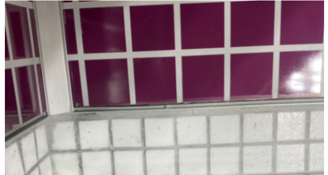
Stedvis manglende tetting i nedkant av våtromsplater.
