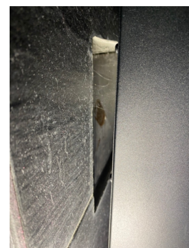
Sotluke plassert i underetasjen
