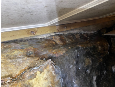
Ising fra vann på innside mur mot terrenget
