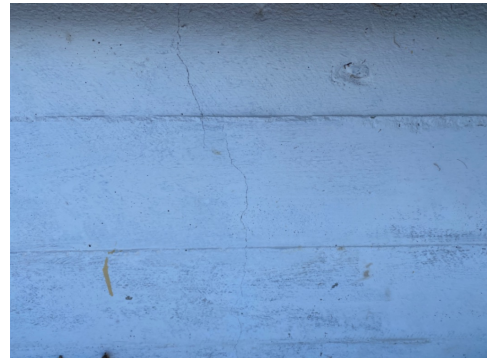
Riss i betongmur.
