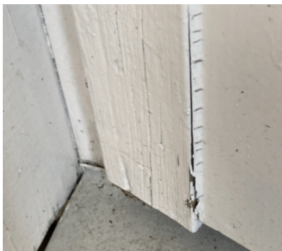
Påbegynte råteskader i nedkant av døren.
