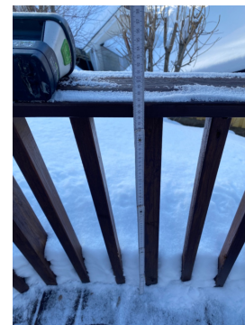
Høyde rekkverk ca. 86 cm. Det bemerkes at det ikke er krav til rekkverk med mindre trappen er over 50 cm. over terrengnivå. Høyde til terrengnivå er ikke målt grunnet snødekt tomt ved befaringsdagen
