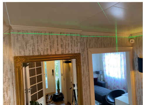
Skjevheter mot taket i undertetasjen
