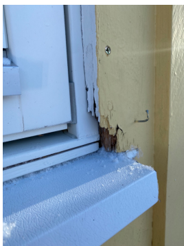
Råteskader i kledningsbord mot karm.
