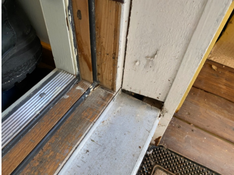
Åpning mellom omramming og beslag.
