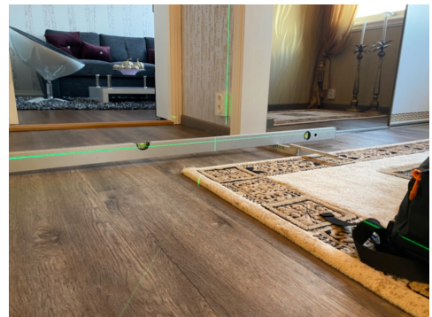
Skjevheter i gulvet i underetasjen.
