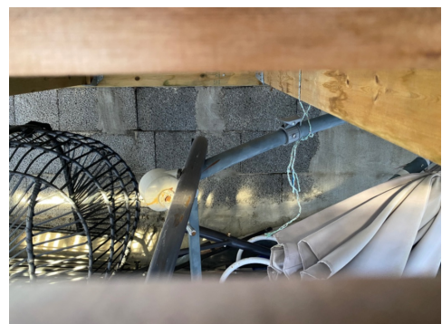
Stedvis manglende murpuss mot lettklinkerblokker.
