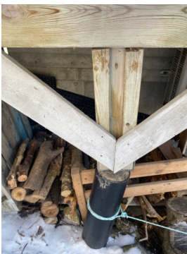
Skjevheter i fundamentering mot søyle.
