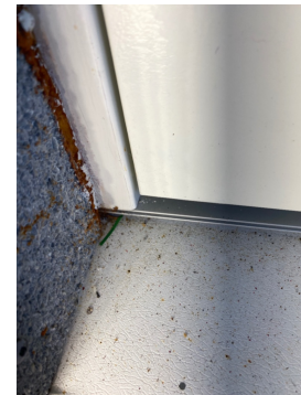
Det er påvist påbegynt svelling mot hörnet på dørblad. Synlig byggsaum.
