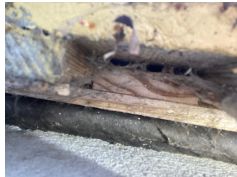
Luftespalte bak kledningsbord. Det bemerkes at åpninger ikke bør være større enn 6 mm. for å kunne forhindre skadedyr. Det er kun foretatt tilfeldige stikkprøver under kledningsbord, det anbefales ytterligere undersøkelser.
