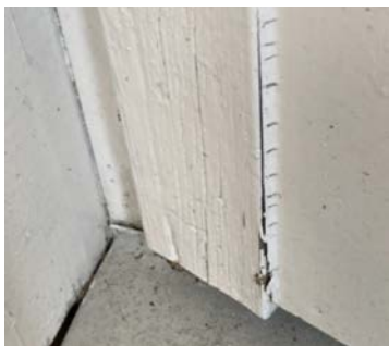
Påbegynte råteskader i nedkant av døren.
