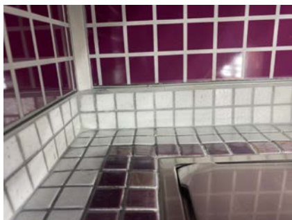
Riss i fuger, ujevn overflate på gulvfliser.
