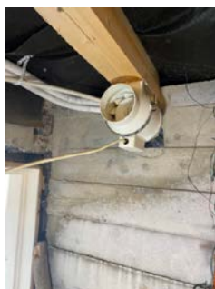
Det er etablert avtrekksvifte i krypkjelleren.
