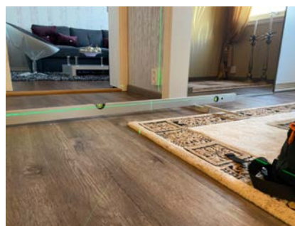
Skjevheter i gulvet i underetasjen.
