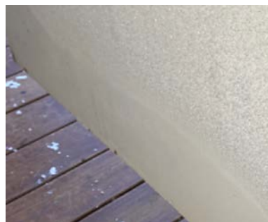
Svellinger mot nedkant av døren.
