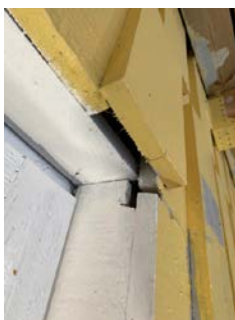
Manglende beslag over døren, samt åpninger mot karm.
