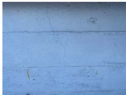
Riss i betongmur.
