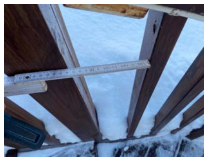
Åpninger i rekkverk fra 10-14 cm.
