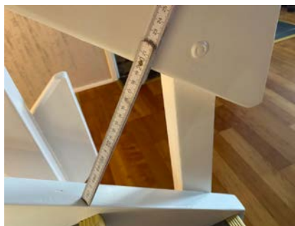
Åpning i rekkverk. Åpninger i rekkverk er større enn dagens forskriftskrav til rekkverk i innvendige trapper.
