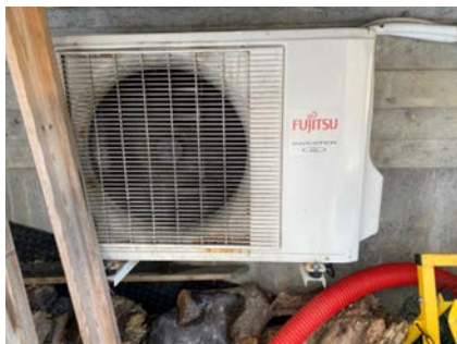
Varmepumpe utvendig del.
