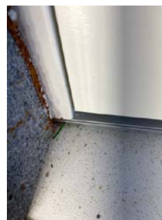
Det er påvist påbegynt svelling mot hörnet på dørblad. Synlig byggskum.
