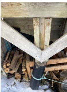
Skjevheter i fundamentering mot søyle.
