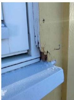
Råteskader i kledningsbord mot karm.
