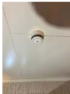
Det er etablert røykvarsler i etasjene.
