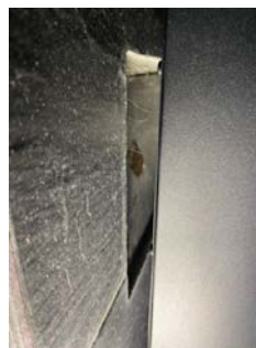
Sotluke plassert i underetasjen
