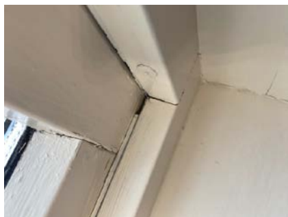
Deler av pakninger i karm mangler på enkelte vinduer.
