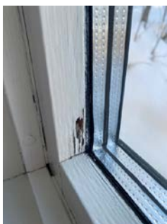
Påbegynt råteskade i vindu på soverom.
