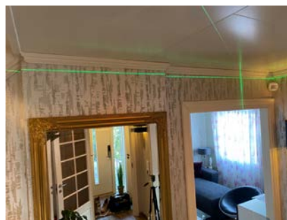
Skjevheter mot taket i underetasjen
