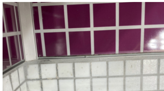
Stedvis manglende tetting i nedkant av våtromsplater.
