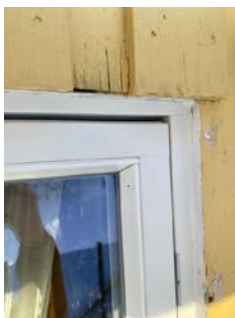
Manglende vannbrett/beslag over dør.
