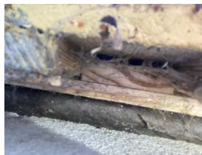
Luftespalte bak kledningsbord. Det bemerkes at åpninger ikke bør være større enn 6 mm. for å kunne forhindre skadedyr. Det er kun foretatt tilfeldige stikkprøver under kledningsbord, det anbefales ytterligere undersøkelser.
