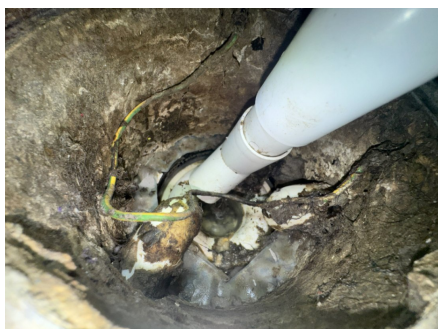
Kontroll av hovedsluk under servantskap.
