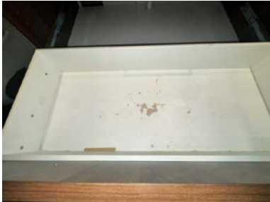
Svelleskader på bunnplate i skuff
