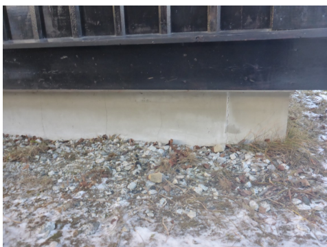
Viser grunnmur med sprekker/riss.
