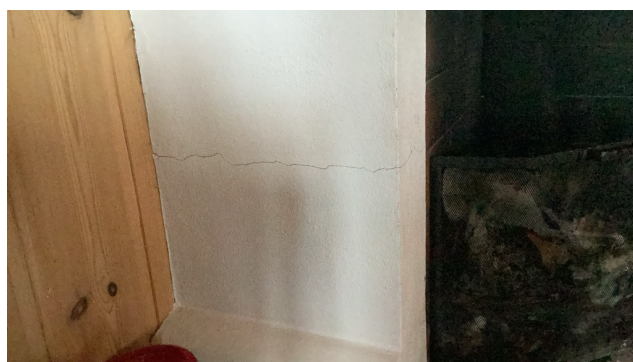
Viser sprekk i peisvange.
