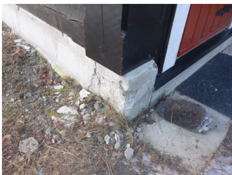
Viser sprekk i grunnmur under yttervegg svalgang v/inngang.
