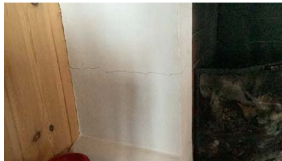
Viser sprekk i peisvange.
