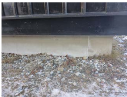
Viser grunnmur med sprekker/riss.
