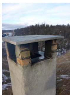
Viser pipe med avskalling av puss på knaster for pipehelle.
