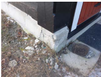
Viser sprekk i grunnmur under yttervegg svalgang v/inngang.
