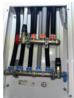
Samleskap med rørkurser og stoppekraner
