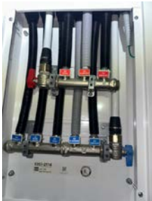
Samleskap med rørkurser og stoppekraner
