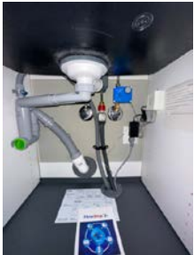
Rørøpplagg i kjøkkenbenk med Waterguard
