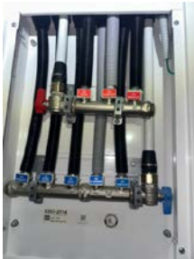
Samleskap med rørkurser og stoppekraner
