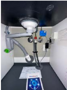
Rørøpplagg i kjøkkenbenk med Waterguard
