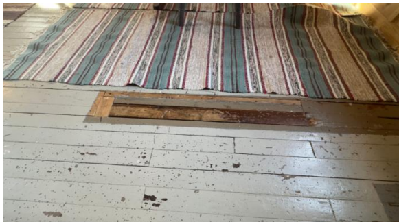
Slitasje og synlige spor etter tidligere vegg.
