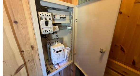
Kontroll av el-skap og kursfortegnelse.
