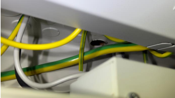
Kabelinnføringer i sikringskap er ikke tilfredsstillende tettet.
