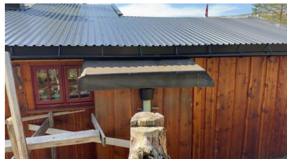
Utstikk ved toalettrom har gammelt taktekke.
