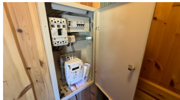
Kontroll av el-skap og kursfortegnelse.
