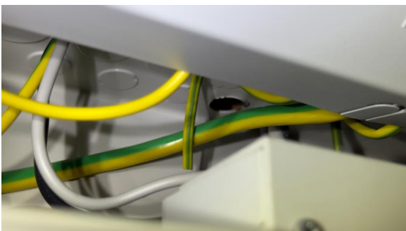
Kabelinnføringer i sikringsskap er ikke tilfredsstillende tettet.
