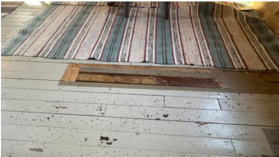
Slitasje og synlige spor etter tidligere vegg.
