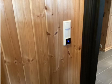
kontrollpanel for gulvvarme.
