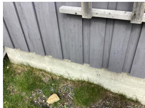
Oppsprukket panel enkelte steder.
