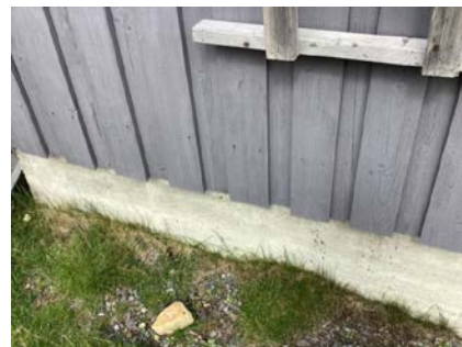
Oppsprukket panel enkelte steder.
