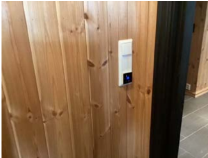
kontrollpanel for gulvvarme.
