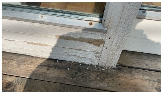
Slittasje i treverk på terrassedør.
