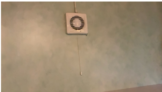
Elektrisk styrt vifte.
