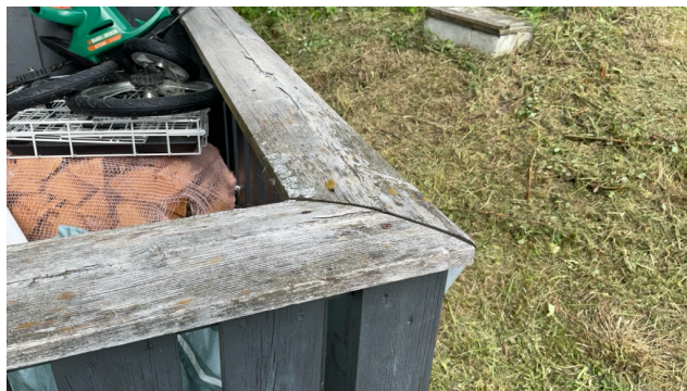
Sprekker i eldre håndrekk.
