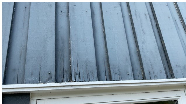
Råteskadet kledning på vegg.
