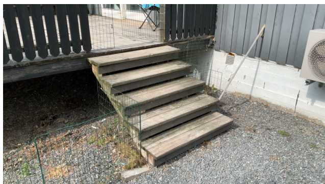
Trapp mangler rekkverk.
