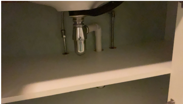
Vannledninger av kobber.
