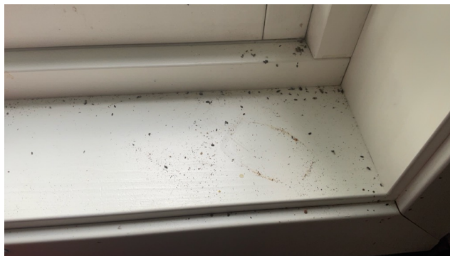
Muselort i vinduskarm i 2 etasje.
