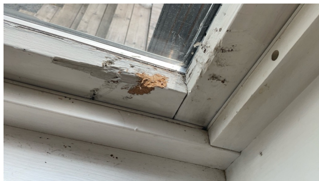
Skade i vindu.
