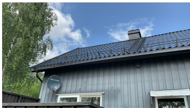
Eksempel på deformasjoner på takrenner.
