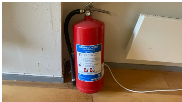
Apparat fra 1999. Bør byttes.
