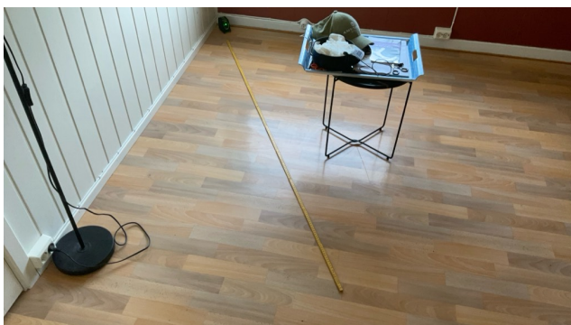
Meterstokk viser hvor avvik er registrert.
