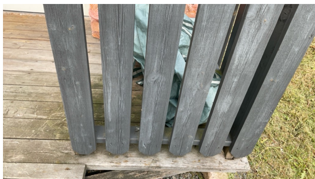
Sprekker i trevirke.
