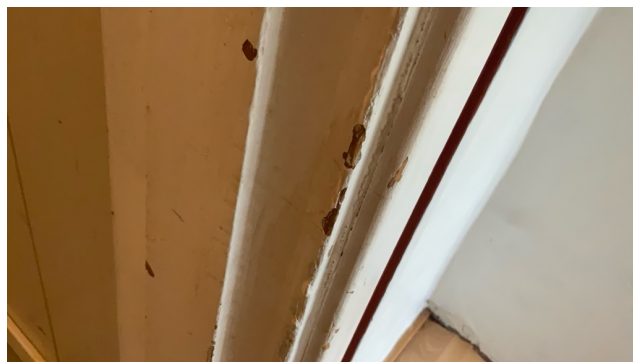
Skade i dør.
