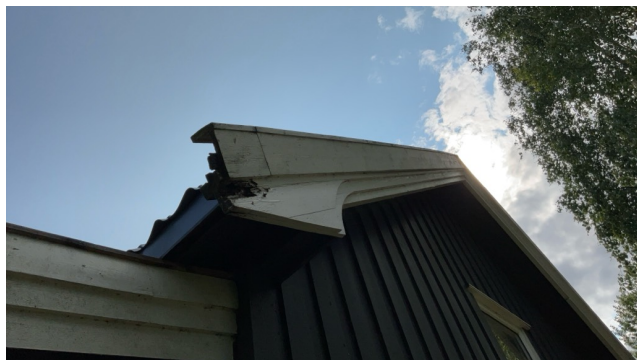
Råteskader i vinds kier/bordkledning.
