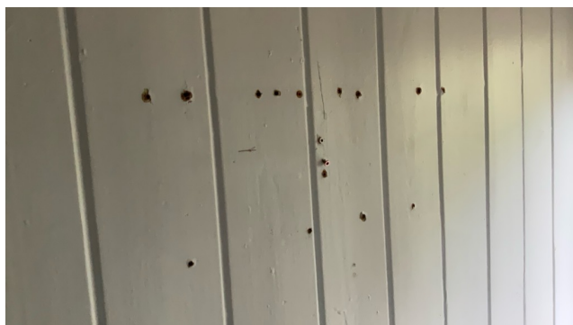
Mange skruehull i vegg.
