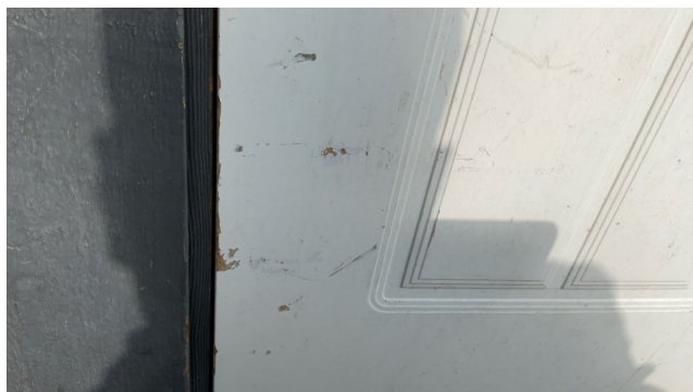
Skader i ytterdør.
