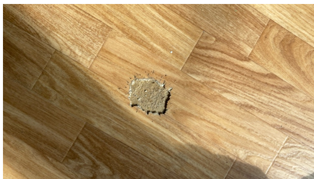
Skade i gulv.
