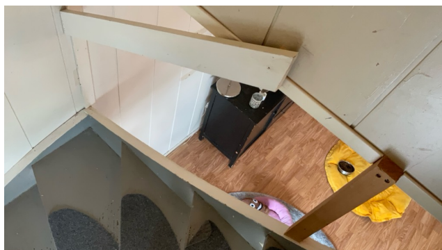
Store åpninger i rekkverk.
