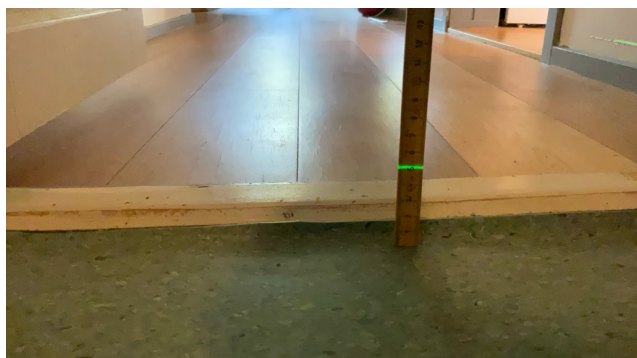
Det er målt 5,0cm på gulv ved terskel.
