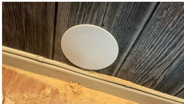
Hull forsvarlig plombert.
